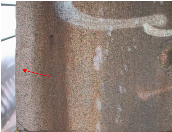
Vorzustand mit einem durch herablaufendes Regenwasser gereinigten Bereich
