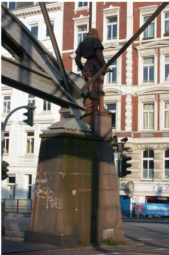
Zustand vor der Reinigung
