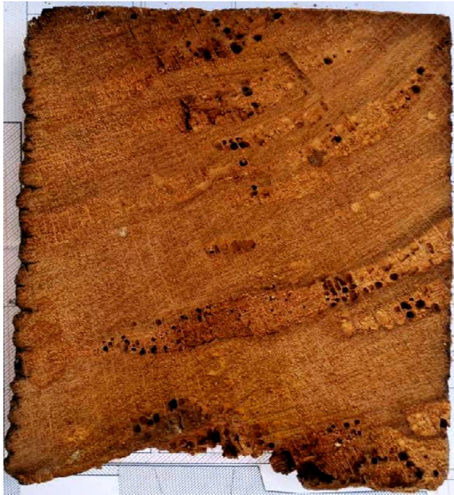
Abb. 97: Pilzlich geschwächte bis vollständig abgebaute Zonen im Eichenholz. Die Befallszonen verteilen sich unregelmäßig über den ges. Holzquerschnitt. Verursacher: Ausgebreiteter Hausporling ( Donkioporia expansa ), Sekundärbefall durch Gescheckten Nagekäfer ( Xestobium rufovillosus )
