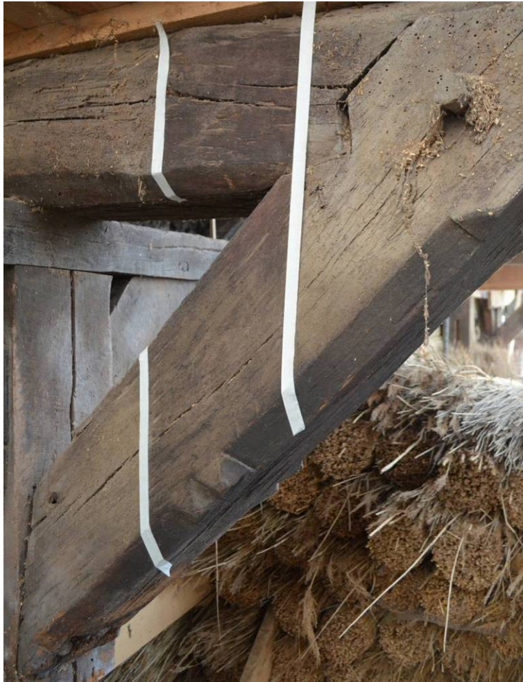
Abb. 99: Reinigungsprobe am westl. Kopfband und Balken in Gebinde VI. Es erfolgten eine Entstaubung (abfegen, saugen) sowie eine Trockenreinigung mit Reinigungsschwämmen. Die Probefläche wurde zur Veranschaulichung mit Papierstreifen gegen angrenzende unbearbeitete Flächen abgetrennt.
