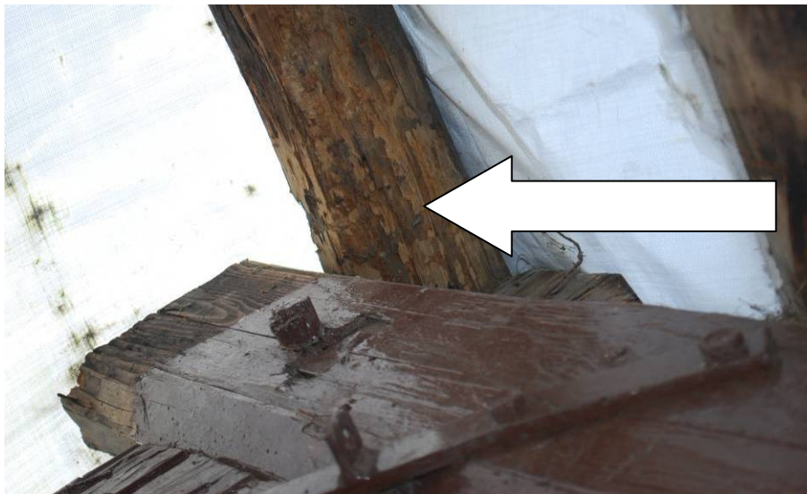
Abb. 35: Detail Südgiebel-Spitze, Gebinde 1 b: Der (wohl erloschene) Befall durch Hausbock erstreckt sich auch auf angrenzende Dachlatten (Pfeil)
