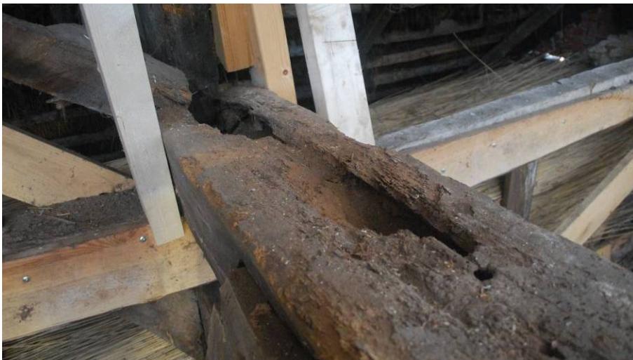
Abb. 63: Beispiel für langjährigen Pilzschaden in Gebinde VIII, Westseite. Durch die undichte Dachhaut lief regelmäßig Niederschlagswasser auf den Balken, z.T. floss es den Sparren hinab und sammelte sich im Sparrentopf des Balkens. Räumlich begrenzt konnten holzerst. Pilze gedeihen und das Holz regelrecht aushöhlen. Nagekäfer verstärken den Effekt.
