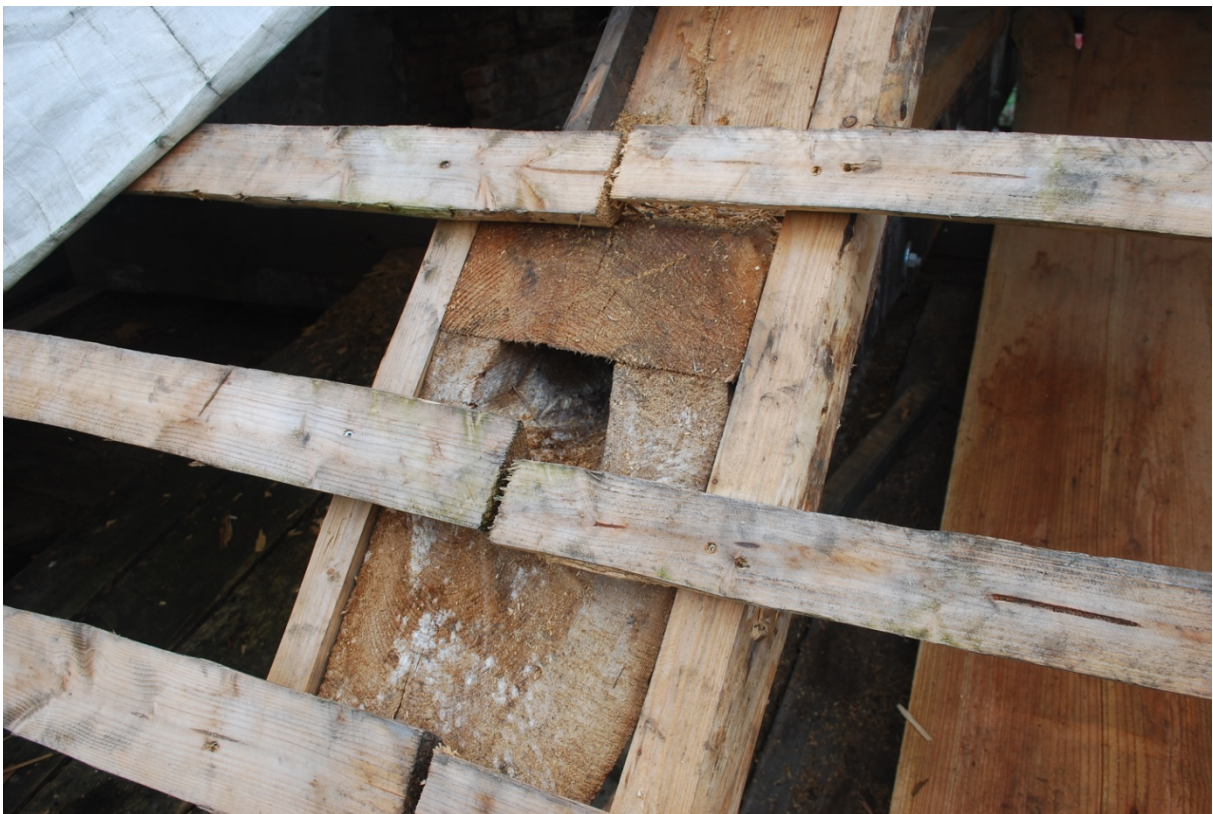
Abb. 41: Das kernfaule Holz wurde ausgeräumt, die morsche Oberseite in Form einer Teilergänzung (Bohle) ertüchtigt. Da der Balkenkopf direkt an die Dacheindeckung reicht und damit nicht mehr einsehbar ist, erfolgte eine Imprägnierung des Befallsbereichs mit einem Bor-Präparat.
