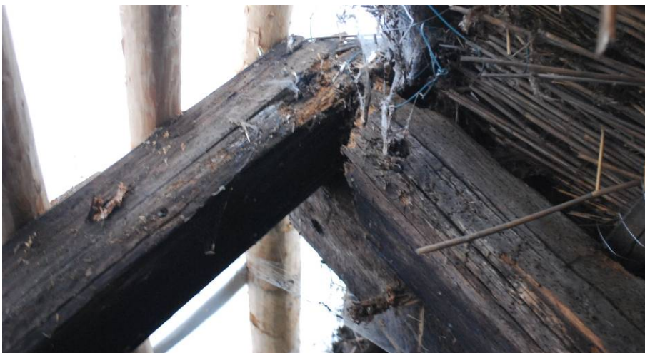
Abb. 54: Geb. VII, Giebelspitze mit defekter Überblattung (restauriert 11.2016)
