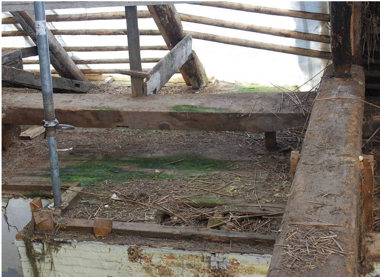
Abb. 82: Beispiel für Besiedlung durch Algen, erkennbar an den grünlichen Belägen der regelmäßig befeuchteten Materialoberflächen. Im Bild die Decke über Raum Nr. 06 zwischen den Gebinden IIII und V.
