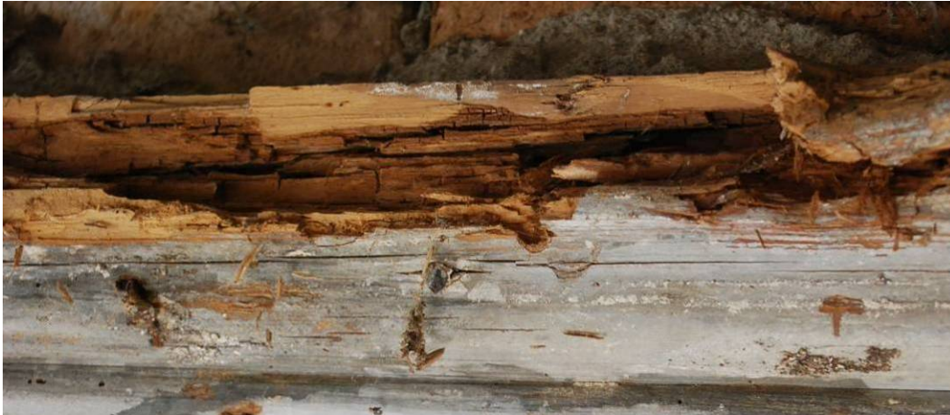
Abb. 16: Raum 3 Südwand, Oberrähm: Durch holzerstörende Pilze „ausgehöhlt“
