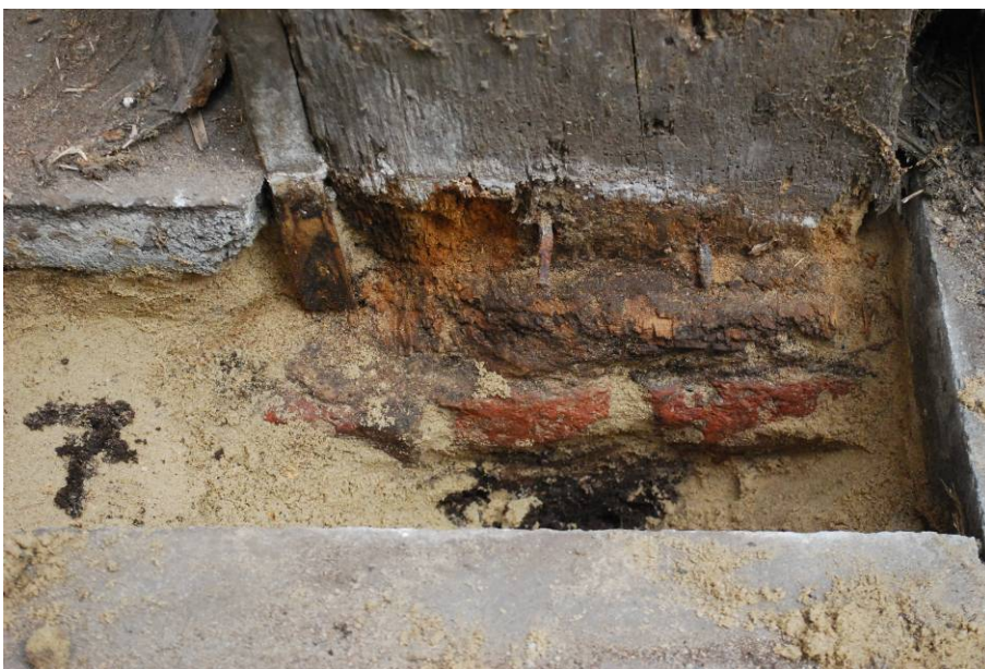
Abb. 49: Gebinde VII, Freigelegter Fußpunkt des östl. Hauptständers: Fundamentierung aus angenagelter Holzplatte, Backstein, Erdreich mit Findlingen. Durch das Anwachsen des Bodenniveaus (Sand, Betonplatten) steht der Ständer feucht.
