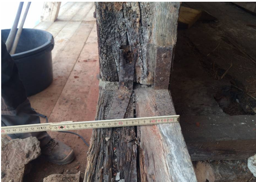
Abb. 20: Stockschwelle 1. OG Raum 11. Die Schwelle besteht aus 2 Bohlen. Je nach Erhaltungszustand partieller Austausch der äußeren Bohle nötig (Foto: Ostermann)
