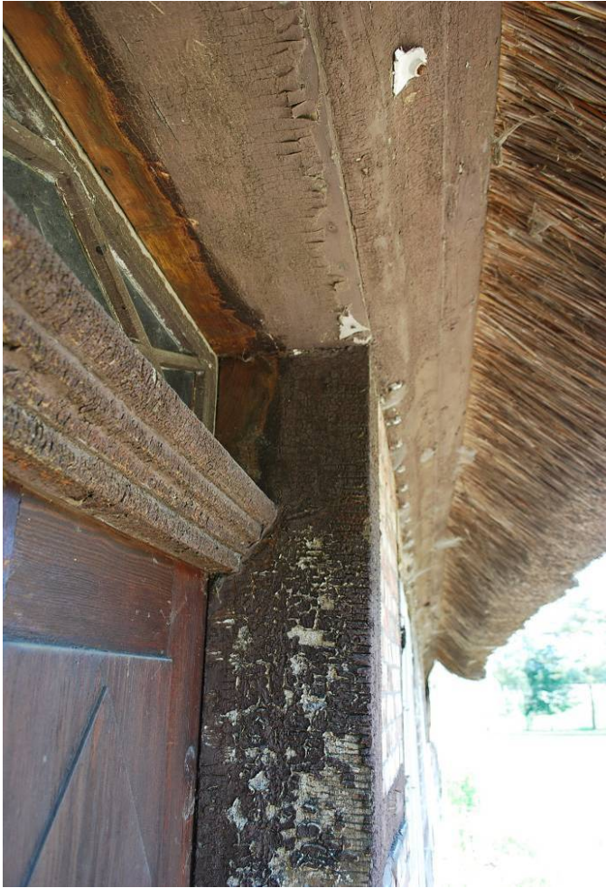
Abb. 07: Ostfassade, Detail Haustür: Abblätternde Fassungsschichten, wohl Leinölanstriche
