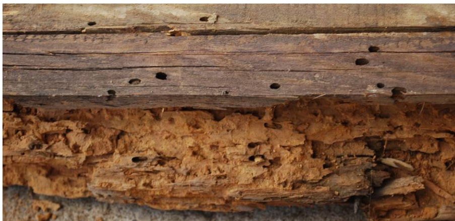
Abb. 36: Detail Ortgang zw. Gebinden 1 b und 1 c, Ostseite: Vollständige Zerstörung des Holzinneeren durch Hausbock. Austausch bereits erfolgt.
