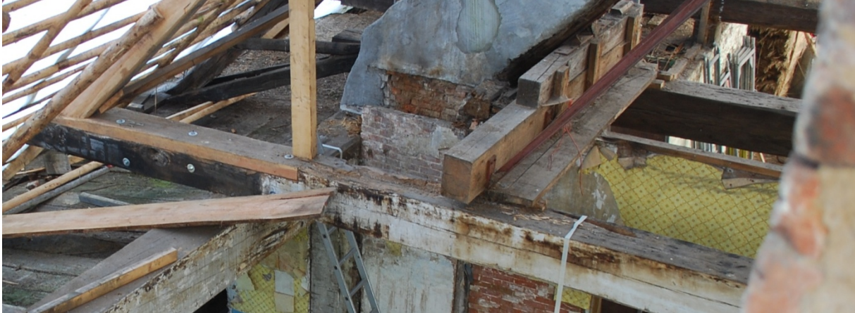
Abb. 40: Westseite Gebinde III, mit erheb. Schaden durch Nassfäule-Pilze (Feuerschwamm) am Balken. Vom Balkenkopf auf einer Länge von ca. 1,5 m ist der Balken hohl; im Bereich des Kamins liegen oberflächliche Schädigungen vor. Bearbeitung bereits erfolgt (s. untenstehende Abb.)
