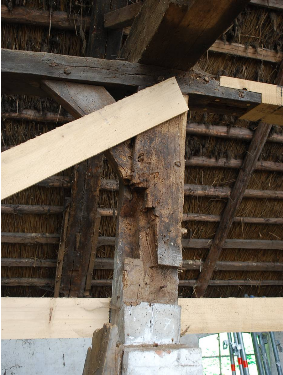
Abb. 50: Gebinde VII, westl. Ständer: Frühere Bauteile haben Spuren hinterlassen. Neben den Blattsassen verweist die helle Stelle am Balken (oben) auf das fehlende Kopfband. Darunter sind Aussparungen für Hillriegel usw. zu erkennen. Das Kopfband sowie die ursprüngliche Hillriegel-Lage sollten rekonstruiert werden, die restl. „Fehlstellen“ werden in Holzart und Maß passgenau ergänzt.
