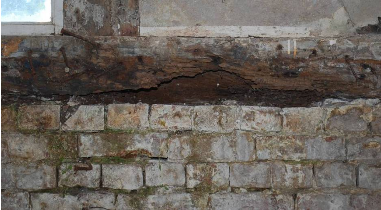
Abb. 19: Hüfriegel, Detail. Massiver Holzverlust durch Pilze und Ameisen. Die Möglichkeit der Erhaltung der oben gelegenen Oberfläche (Fensterbank) ist gegeben.
