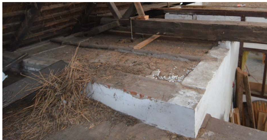
Abb. 27: Die Decken- „Balken“ über Raum 08 weisen intensiven Befall durch Nagekäfer ( Anobium punctatum ) auf; sie sollten ausgetauscht werden.
