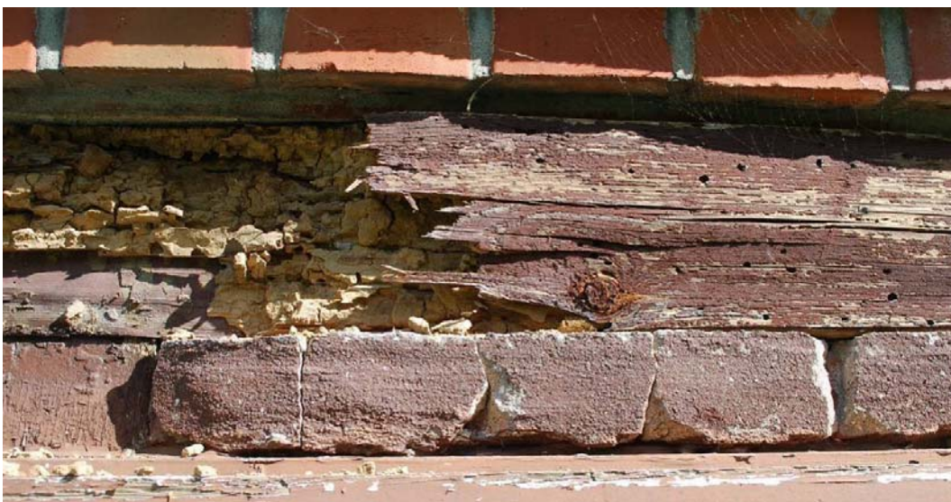
Abb. 13: Detail, Lage am Bau s. Abb. 12. Die Beplankung weist äußerlich einige Fluglöcher von Hausbock-Käfern auf. Bei Abnahme der Oberfläche wird die vollständige Zerstörung des Holzinnersen durch Hausbock-Larven erkennbar.
