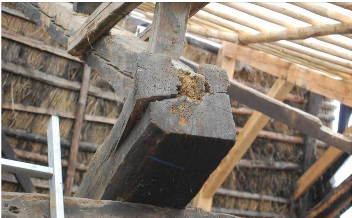
Abb. 56: Beispiel für langjährigen Pilzschaden in Gebinde VII, Ostseite. Anamnese wie bei vorstehender Abb., mit dem Resultat, dass das abgebaute Holz des Balkenkopfs unter dem Druck des Sparrens barst
