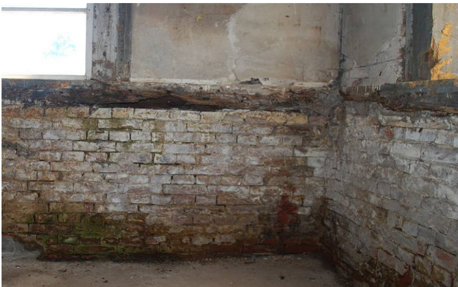
Abb. 18: Raum 3, Südost-Ecke; entspricht östl. Ecke Südfassade: HZP und Ameisen im Rähm. Die deutlich erkennbare Feuchtigkeit am Sockelmauerwerk resultiert aus der ungünstigen Geländeneigung außen.
