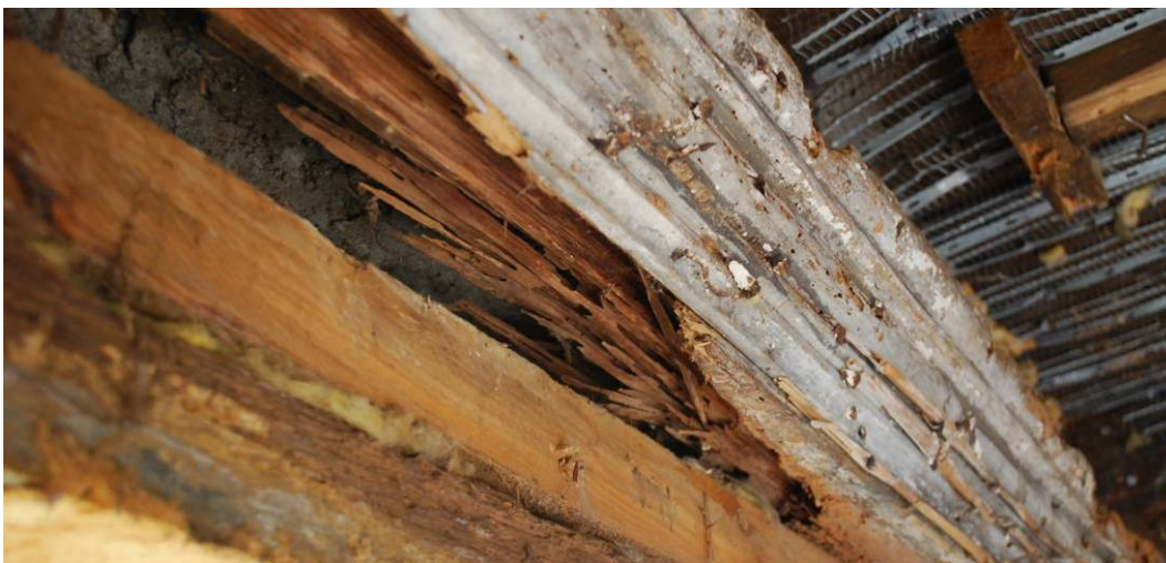
Abb. 17: Raum 3 Südwand, Oberrähm: Nach vorangegangenem Pilzschaden (s. Abb. 16) besiedelte die Braune Wegameise den Balken, das morsche Holz wurde ausgeräumt.
