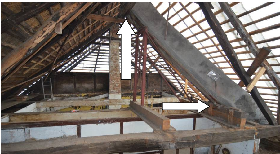
Abb. 28: Die den Schornstein stützenden Balken sind z.T. morsch → Austausch
