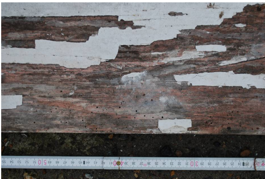
Abb. 30 und 31: Schadbilder ausgemusterter Bretter der Decke über Raum 11
