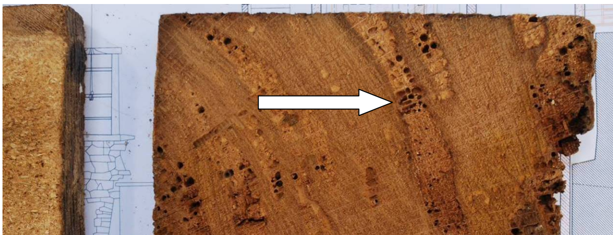
Abb. 68: Abschnitt eines Eichenbalkens (Kantenlänge 22 cm) mit Befall durch Hausporling, als streifige Verfärbungen erkennbar. Der Sekundärbefall durch den Gesch. Nagekäfer beschränkt sich weitestgehend auf die pilzlich geschädigten Bereiche, nur vereinzelt finden sich Fraßgänge im gesunden Holz.
