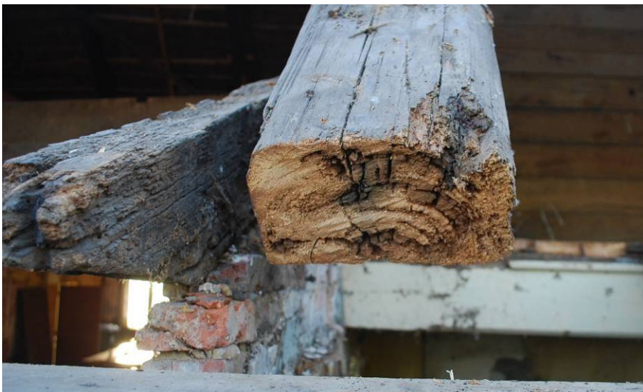
Abb. 39: Partiiell durch Pilze und Insekten geschädigter Sparren (Gebinde 1 west). Die Tragkraft im Fußpunkt ist durch den Holzabbau um ca. 50 % reduziert. Der Fußpunkt muss erneuert werden.
