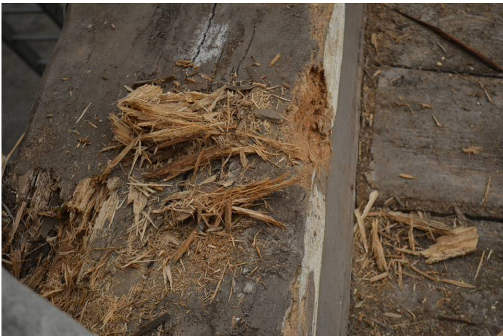
Abb. 77 Durch Feuerschwamm verursachte Weißfäule (Unterzug zw. Geb. III u. IIII)
