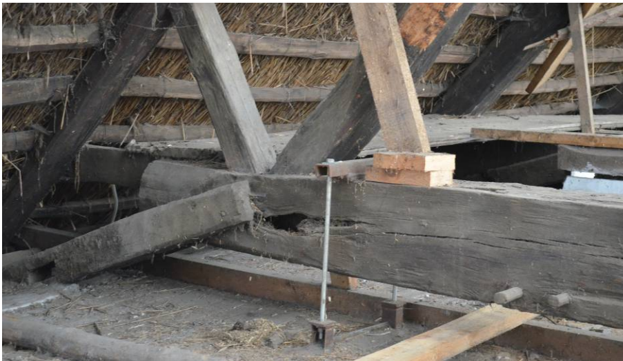
Abb. 46: Gebinde IIII Ostseite: Balkenkopf hohl. Ertüchtigung notwendig.
