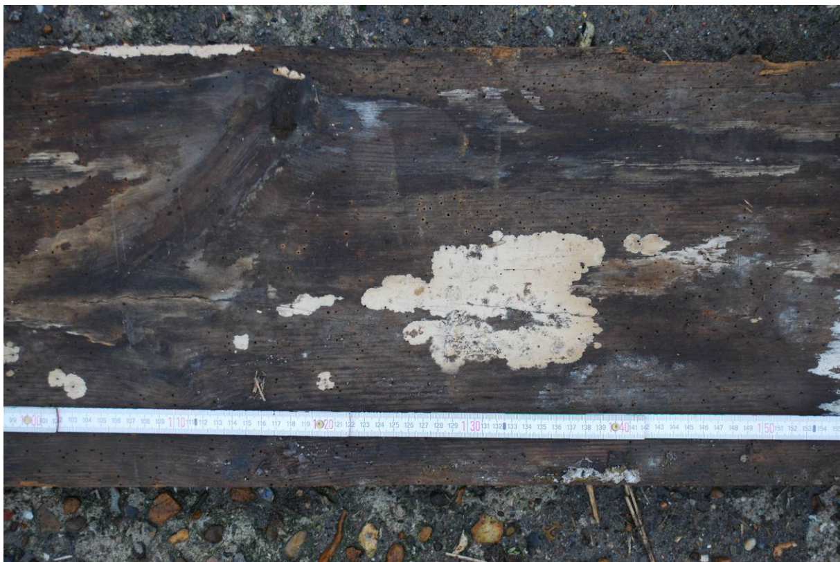
Abb. 32 und 33: Ausgemusterte Deckenbretter aus Raum 11 mit Befall durch holzerstörende Pilze und Insekten
