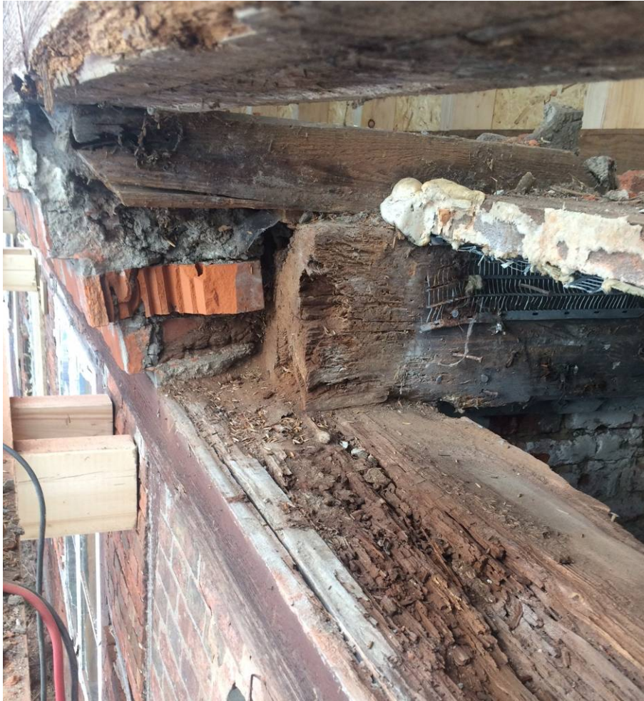
Abb. 14: Balkenkopf der Decke aus Raum 3, beim Rückbau der getreppten Steine. Darunter das geschädigte Rähm, für das ein Teil-Austausch unter Beibehaltung der profilierten OfI. empfohlen wird.
