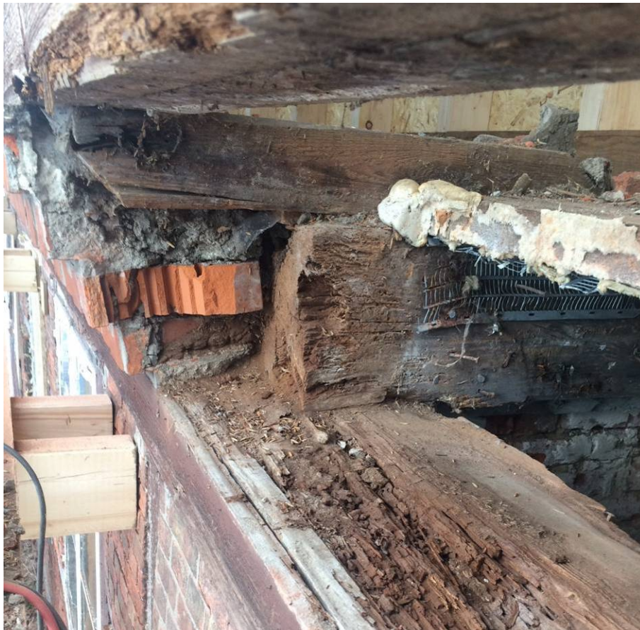
Abb. 24: Deckenbalken von Raum 3 (Streichbalken zu Raum 4), sichtbar durch das abgenommene Ziegelgesims vom Südgiebel aus. Von außen nicht sichtbar weist der Balkenkopf Schäden durch Pilzbefall auf. Eine Sanierung des Balkens erscheint in diesem Falle nicht angezeigt 2 , da hier 1.) lediglich der Balkenkopf betroffen ist; und 2.) der Balken vollständig auf der Trennwand zw. den Räumen 3 und 4 aufliegt und von oben keine weiteren Lasten einwirken (außer Bodenbelag). (Foto: Ostermann. Eine Begutachtung des Balkenkopfs konnte nicht erfolgen)
