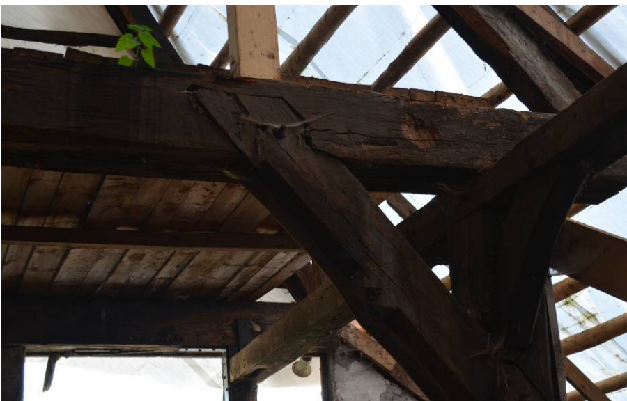
Abb. 66: Gebäude VIII – Grünpflanzenwuchs als Folge von Durchfeuchtung am Balken → trockenlegen!
