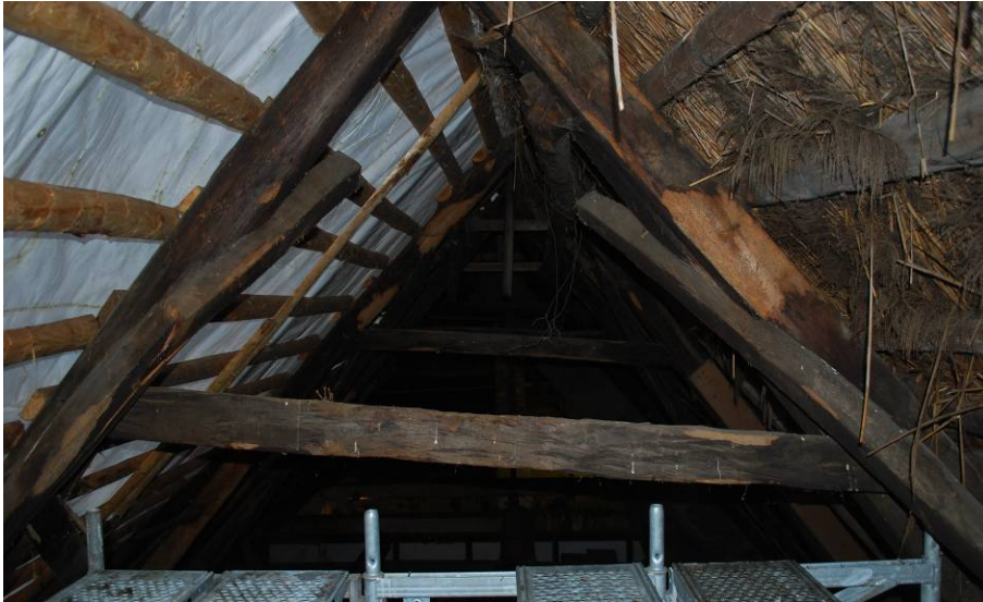
Abb. 52: Zustand Hahnenbalken in Geb. VII, Blick nach Süd. Die Windrispe links ist auf Höhe des Sparrens gebrochen (bereits restauriert; 12.2016)
