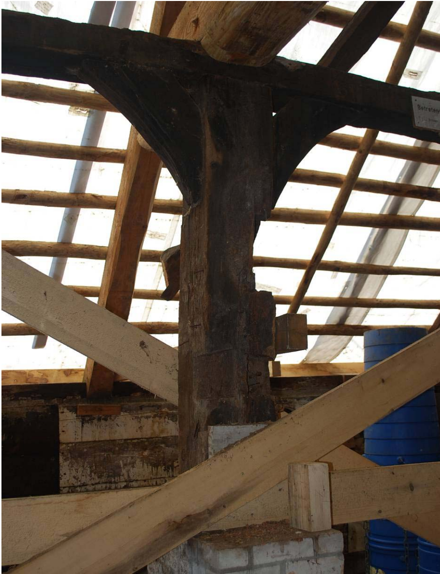
Abb. 57: Östl. Ständer mit neuem Balken. Die Schwächungen des Ständers durch Eintiefungen sollten für rekonstruierte Bauteile (Hillriegel) genutzt werden, ansonsten Ausklotzungen.
