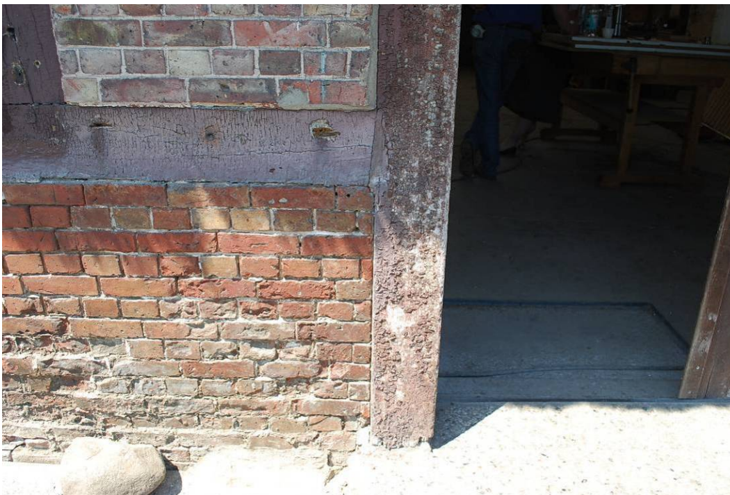
Abb. 08: Ostfassade, Detail Haustür: Grobschollig abblätternde Fassungsschichten
